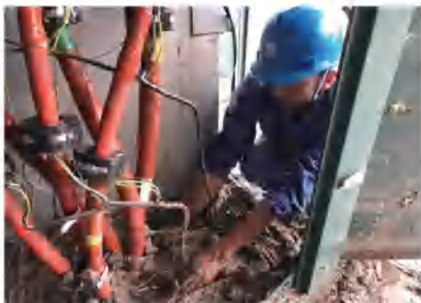
市供电公司员工在“8·18”洪灾中清理电力开关柜中的淤泥（市供电公司 供）
